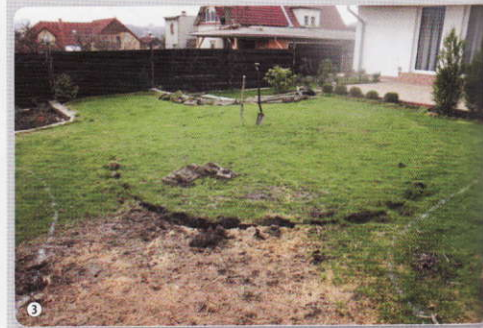
Okamžitě začínají zemní práce. Lopata, kolečko, rýč, ruce na které čeká bezmála 12 m 3 zeminy k odstranění
